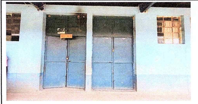
Foto 7: puertas de salon 1 necesita mantenimiento
