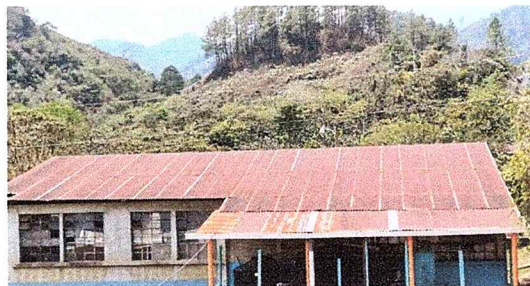
Foto 2: láminas deterioradas parte de atrás. Aula 1
