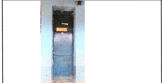
Foto 8: puerta 2 necesita mantenimiento
