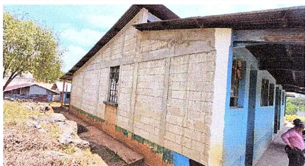
Foto 15: se necesita pintura exterior
