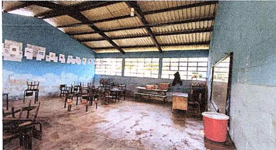
Foto 19: se necesita pintura interior, ambiente 1
