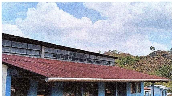
Foto1: láminas deterioradas parte de enfrente. Aula 1
