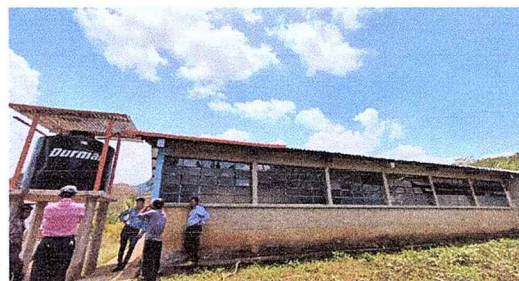
Foto 16: se necesita pintura exterior
