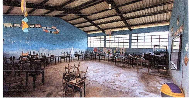
Foto 20: se necesita pintura interior, ambiente 2
